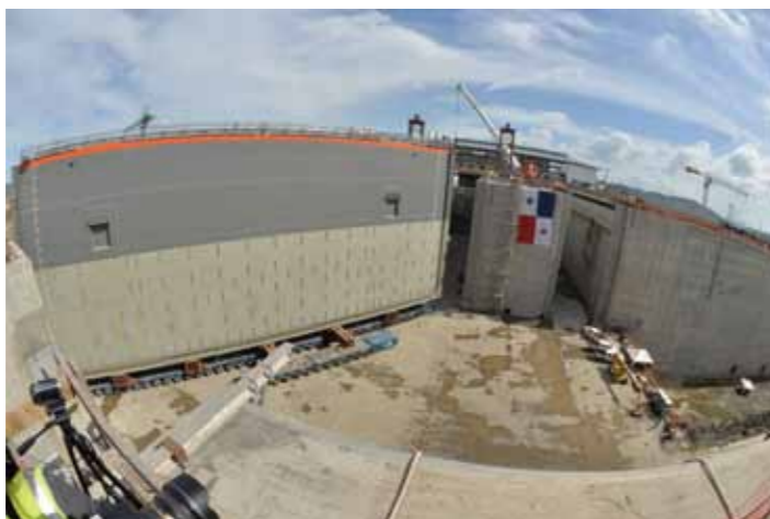
Die gigantischen Schleusentore werden in ihre Parkposition gefahren. Die neuen Schleusen verfügen zum Teil über doppelte Tore
